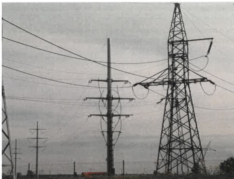
Fot. 3. Linie dystrybucyjne 110 kV (przykłady słupów)
